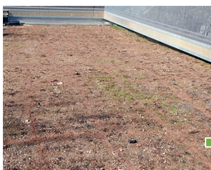
Tak med manglende skjøtsel
