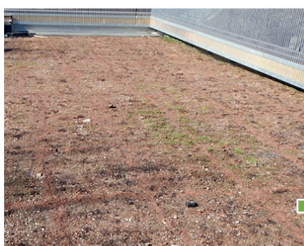
Tak med manglende skjøtsel
