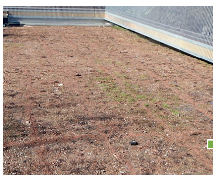
Tak med manglende skjøtsel
